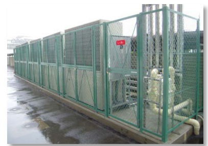
ガス空調室外機
