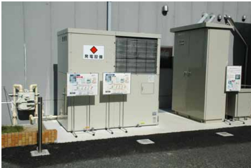
本社南館に設置したガスエンジン発電機
