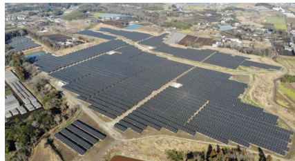
袖ヶ浦太陽光発電所
