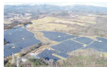
岩手県一関市MS発電所 (設備容量14.9MW)(2022.4出資)
